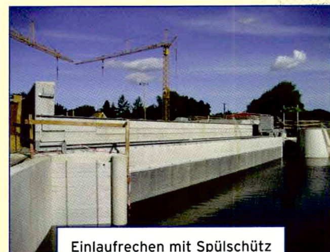
Einlaufrechen mit Spülschütz August 2008
